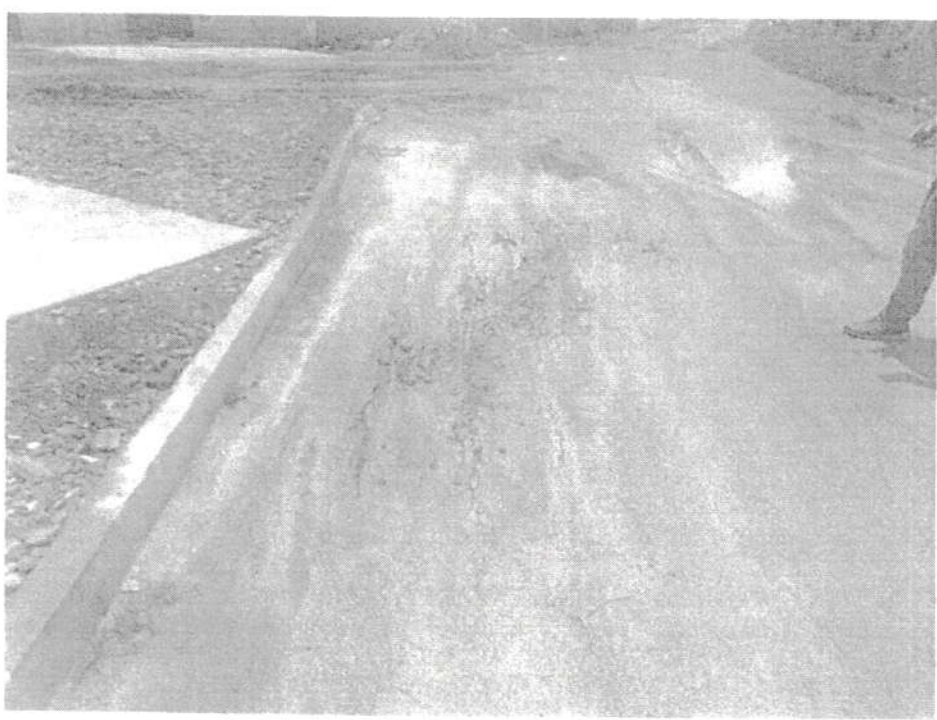
Figuras 03 e 04 – Trechos com surgimento de trincas e afundamentos
