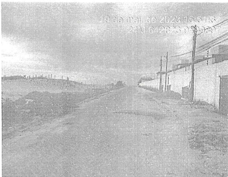
Foto 3(trecho 5) - Na mesma rua identificamos o meio fio danificado pelo tráfego de veículos e lançamento irregular de resíduos. Esse tipo de problema caracteriza também problemas que surgem após conclusão da obra. Nesse caso a empresa não tem como ser responsabilizada.
