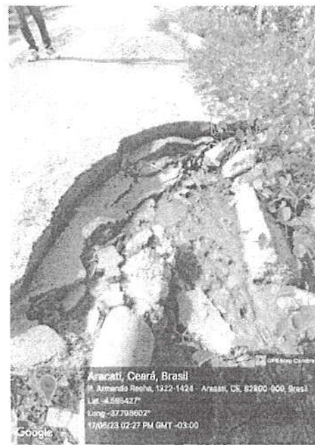
Foto 08: Ao longo do trecho da rua é possível notar a ausência de sinalização (ver anexos) e patologias no asfalto resultados da erosão e da ausência de descidas d'água (ver anexos)
