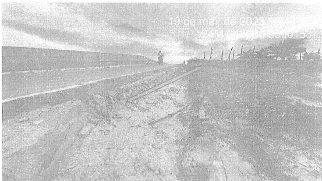
Foto 2 (trecho 5) - Erosão lateral provocada pela velocidade e volume de água superficial gerado na via. Observação: Na data da Foto a empresa já tinha corrigido o problema com uma melhoria. Podemos identificar uma contenção de pedra argamassada para dar sustentabilidade ao meio fio.
