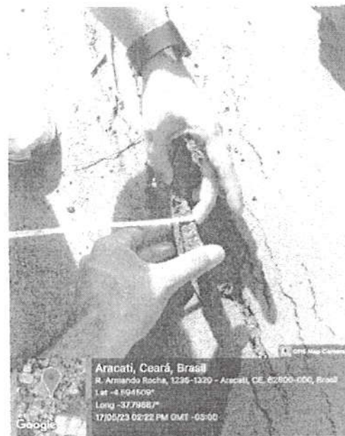
Foto 16: Patologias identificadas em diversos trechos vistoriados, espessura de do asfalto utilizado (ver anexos)
