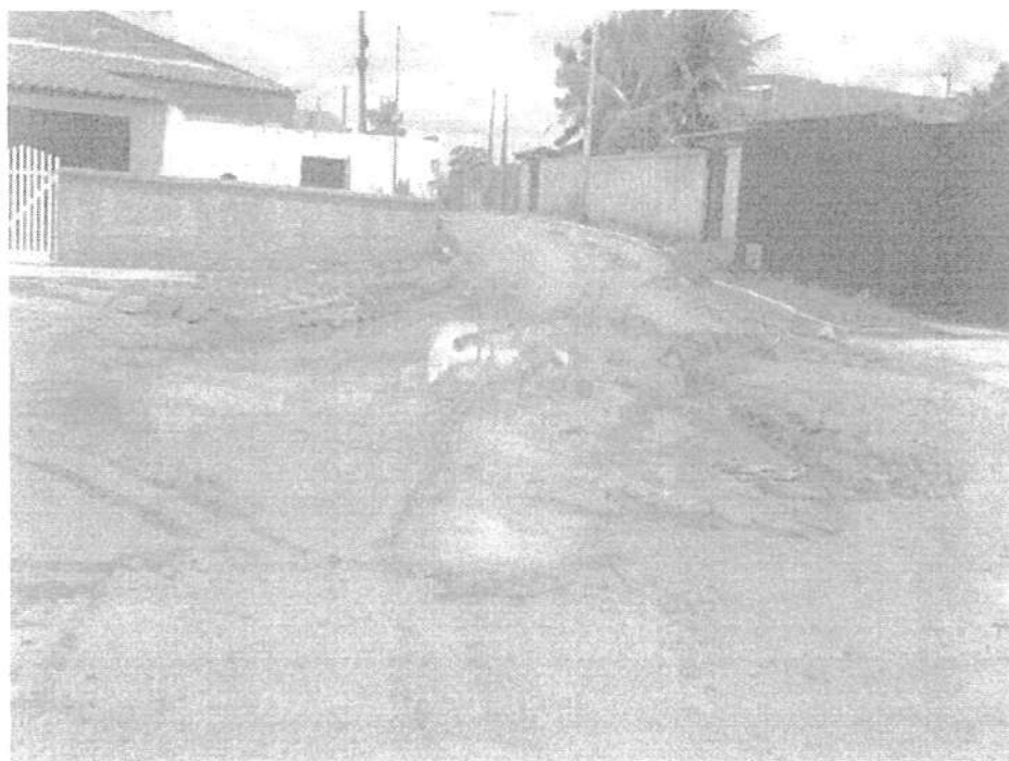
Figuras 05 e 06 – Trechos com revestimento asfáltico todo comprometido
