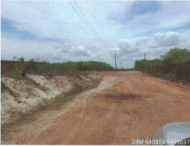
Vista geral da estrada e um problema de acúmulo de água
