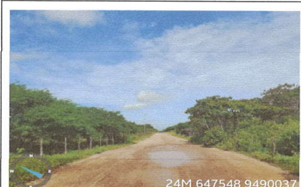
24M 647548 9490037 Visão da estrada em local de alagamento
