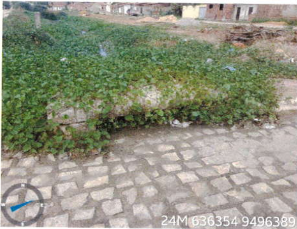
Caixa de drenagem - Início da Galeria
