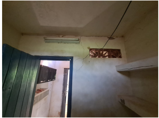
Vista de um dos problema estruturais
