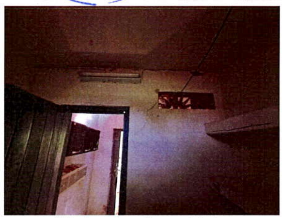
Vista de um dos problema estruturais
