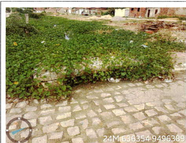
Caixa de drenagem - Início da Galeria
