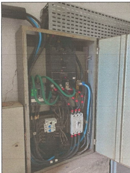
Imagem 1 – Quadro de alimentação de energia
