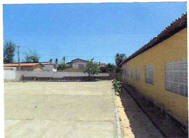
Quadra Poliesportiva com piso morto executado sem condições de uso
