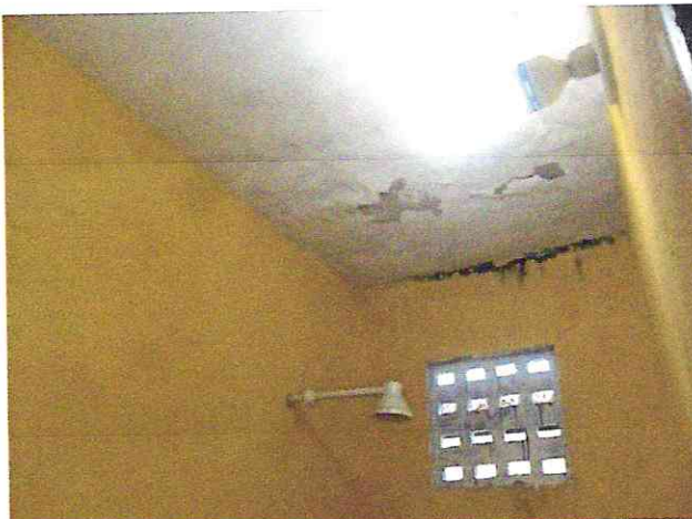
Infiltração na laje da caixa d'água
