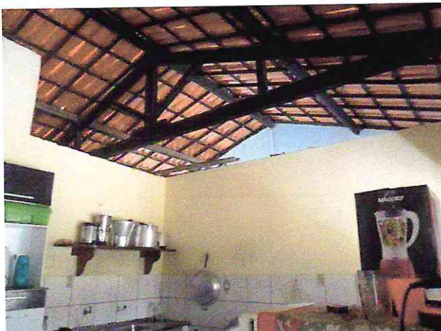
Alvenaria de fechamento da cozinha incompleta
