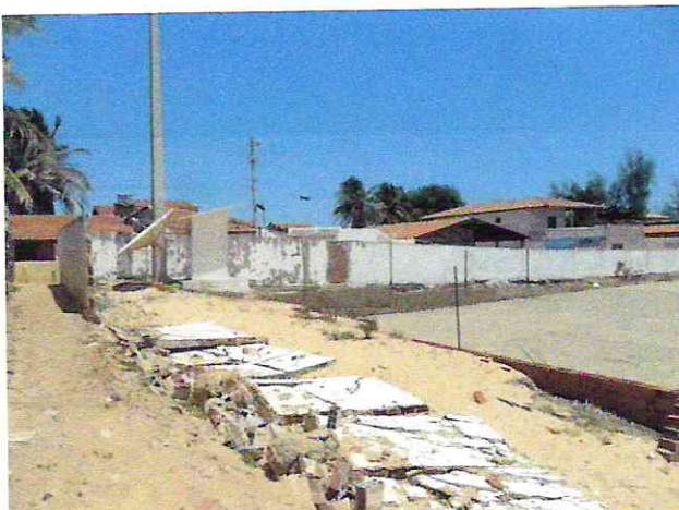
Muro da EEF Heriberto Porto a ser reconstruído
