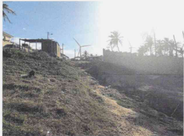
Observações: Rua de acesso à praia em processo de erosão causado pelo escoamento das águas pluviais.
