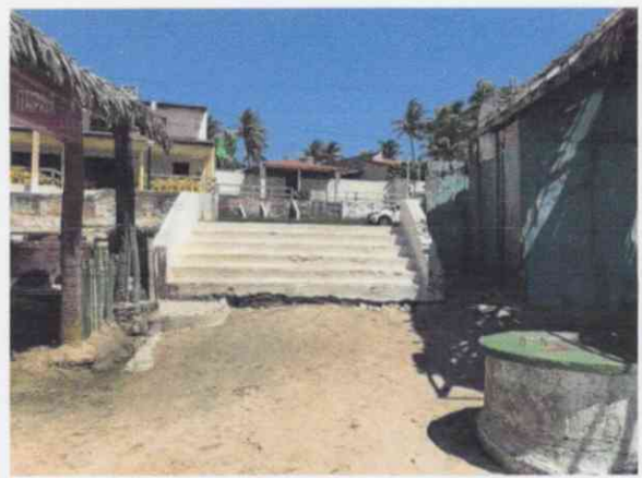
Observações: Escada existente com ausência de acessibilidade.
