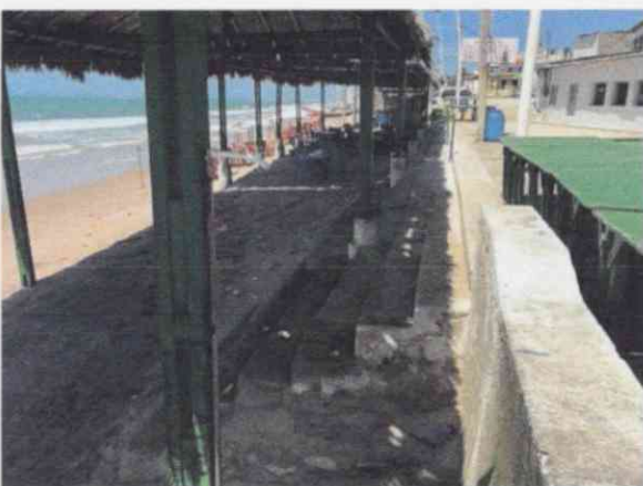
Observações: Escada existente com ausência de acessibilidade.
