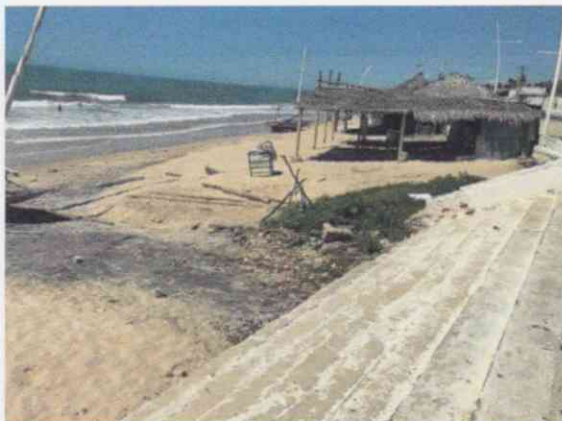
Observações: Escada existente com ausência de acessibilidade e erosões.
