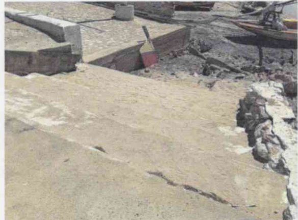
Observações: Escada e rampas existentes com ausência de acessibilidade.
