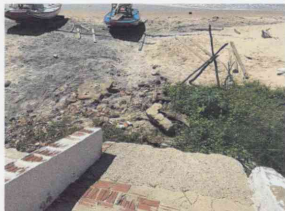
Observações: Rampa existente fora dos padrões e muito danificada.
