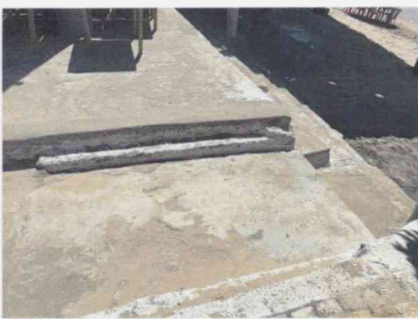
Observações: Calha de drenagem no calçadão existente para encaminhamento das águas pluviais.
