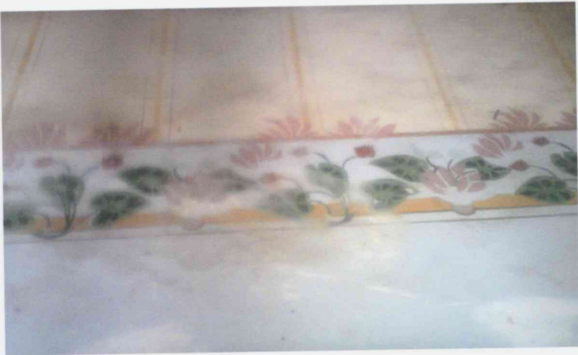
Imagem 02: Barra decorativa com motivos fitomórficos encontrada em dormitório, situado no primeiro pavimento.
