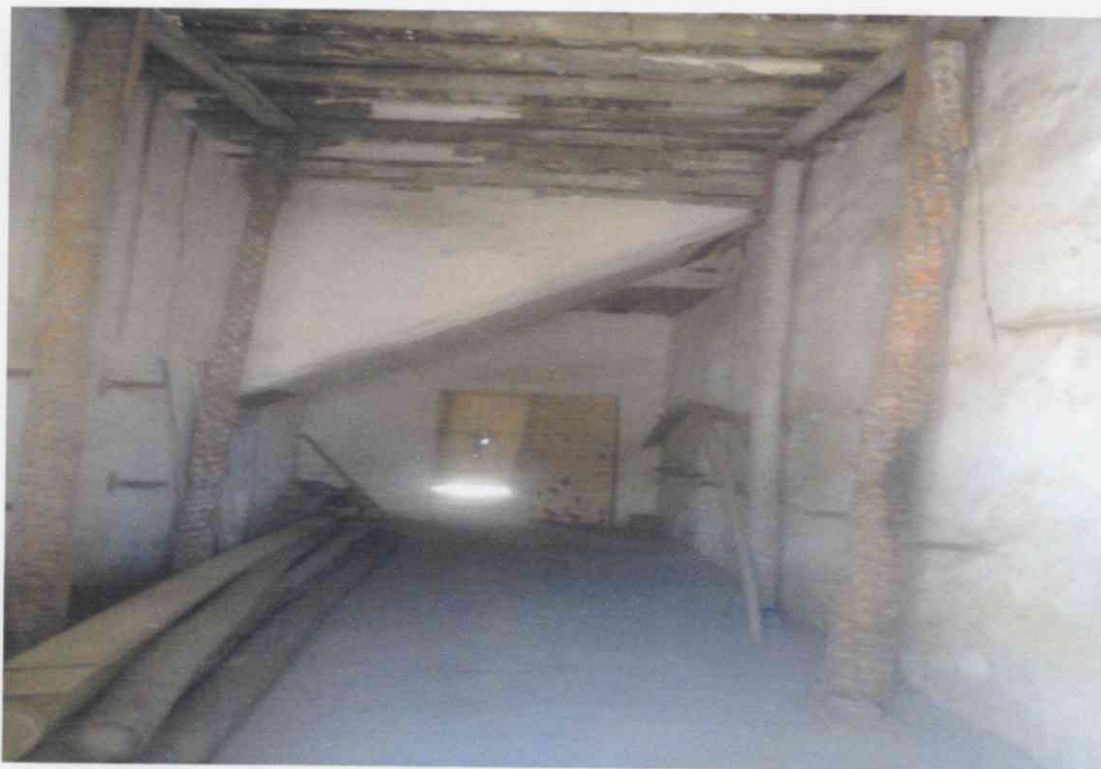
Imagem 08: Vista do depósito, no pavimento térreo, com destaque para o estado precário estado da estrutura do piso do primeiro pavimento.
